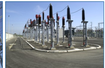
Sottostazioni di trazione
