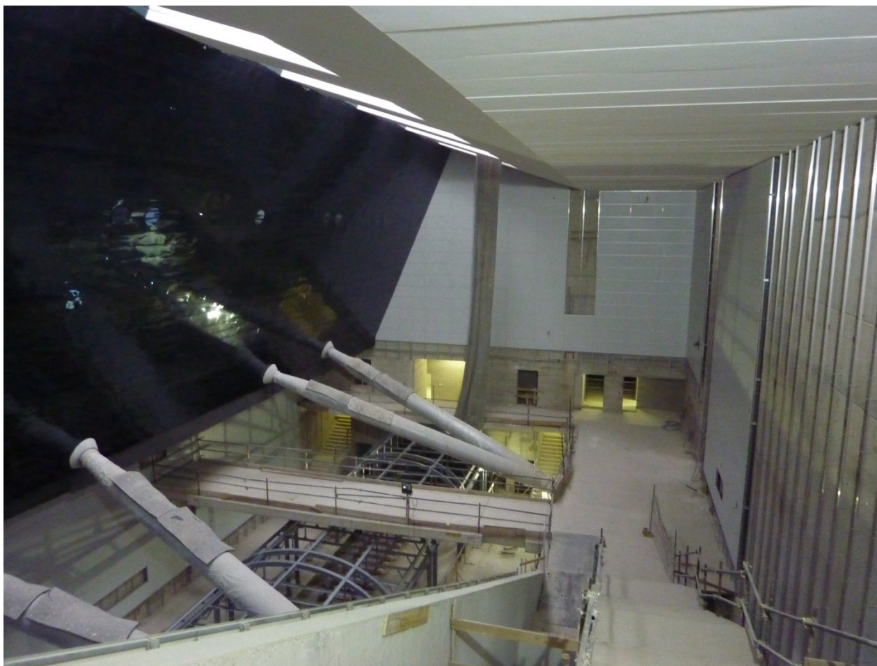
Metro Brescia – stazione tipo profonda
