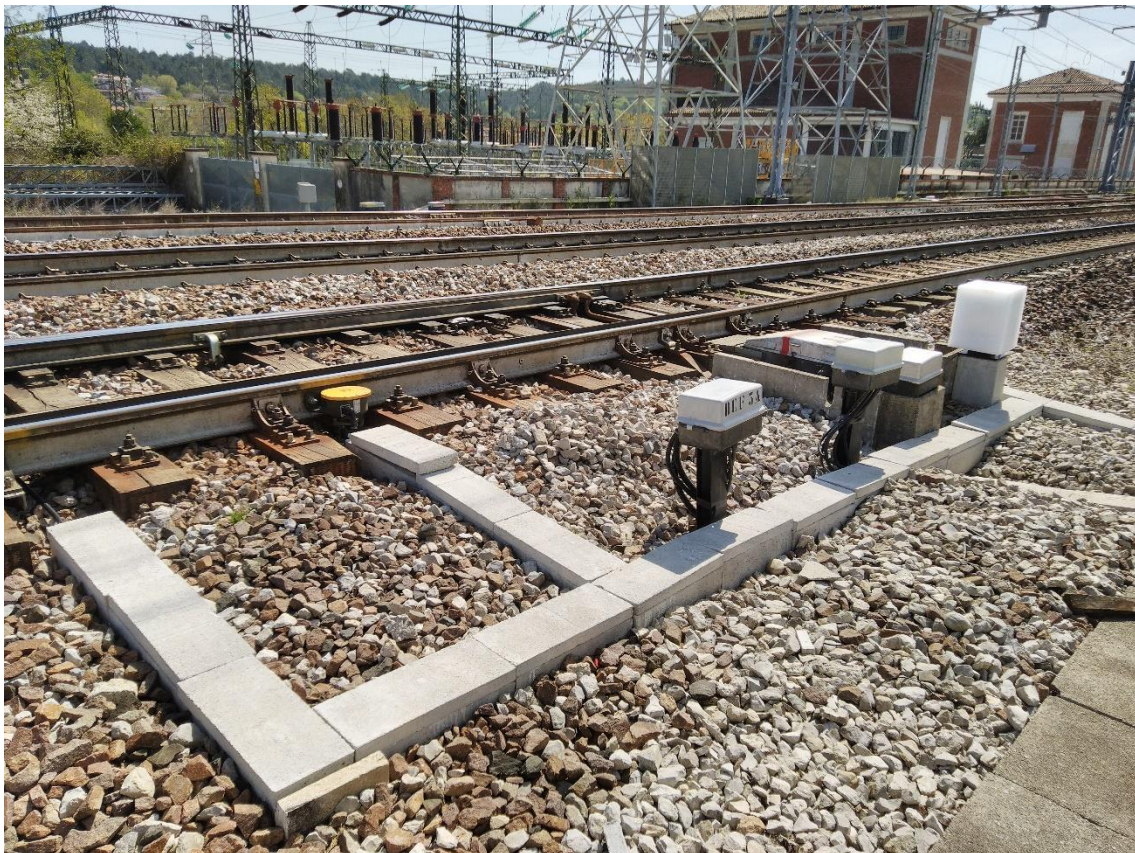
Deviatoio A con CSC
