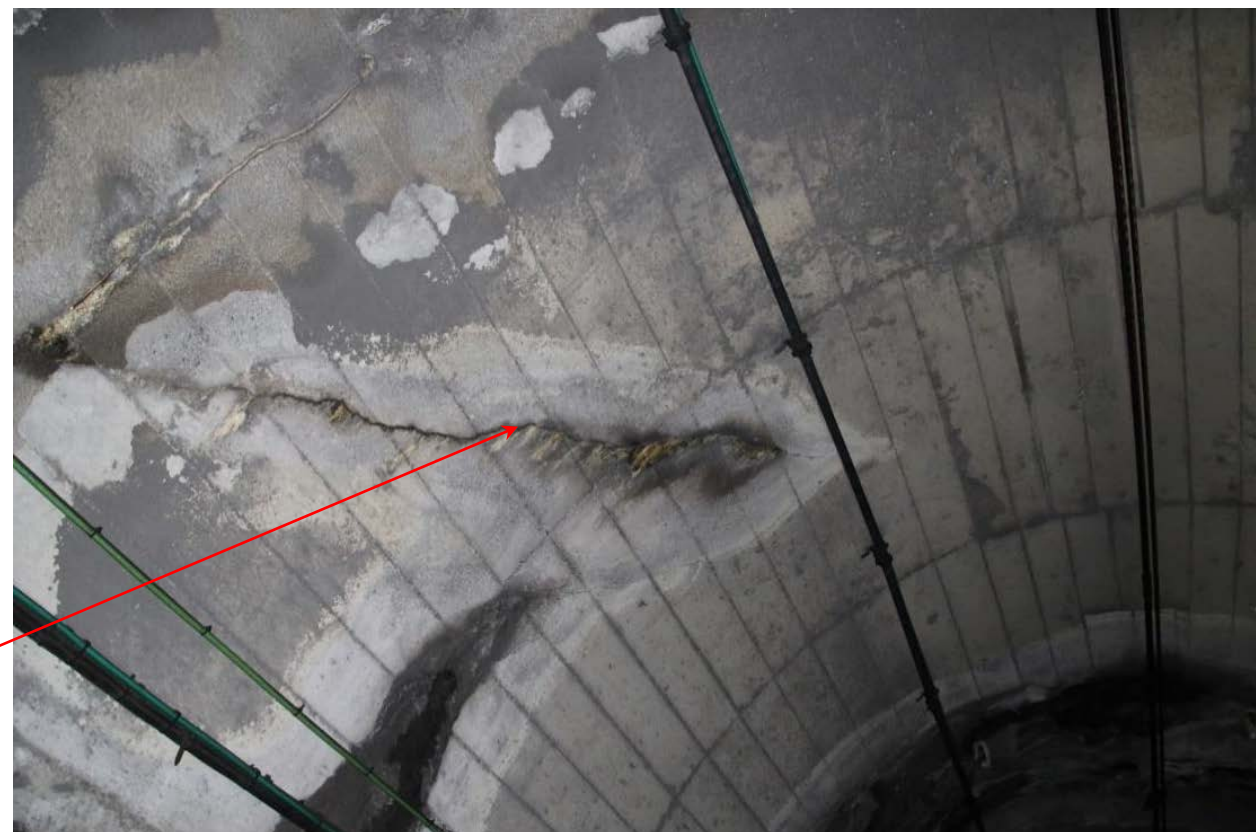
Fessura a 45° tra le nicchie 61 e 62.
