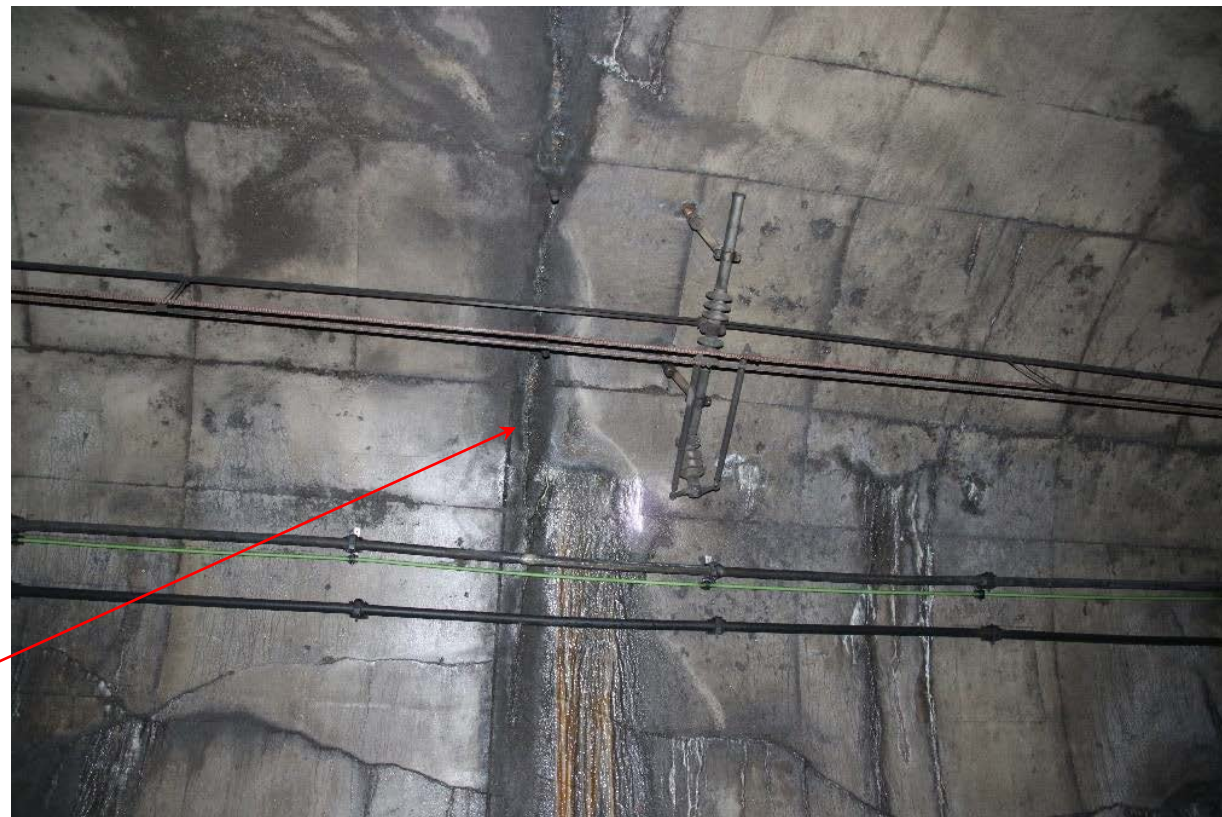
Percolazioni diffuse in corrispondenza della nicchia 16
