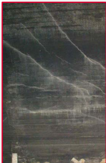
Lesioni e fessurazioni
