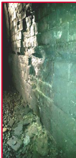
Sfaldatura e distacco del rivestimento
