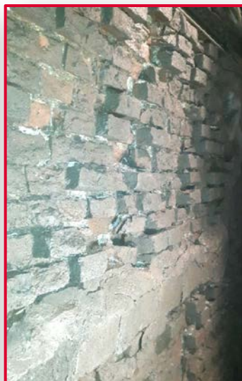
Espulsione della muratura-perdita di malta nei giunti
