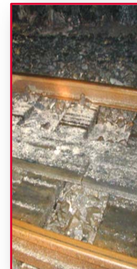
Inquinamento della massicciata per risalita di acqua
