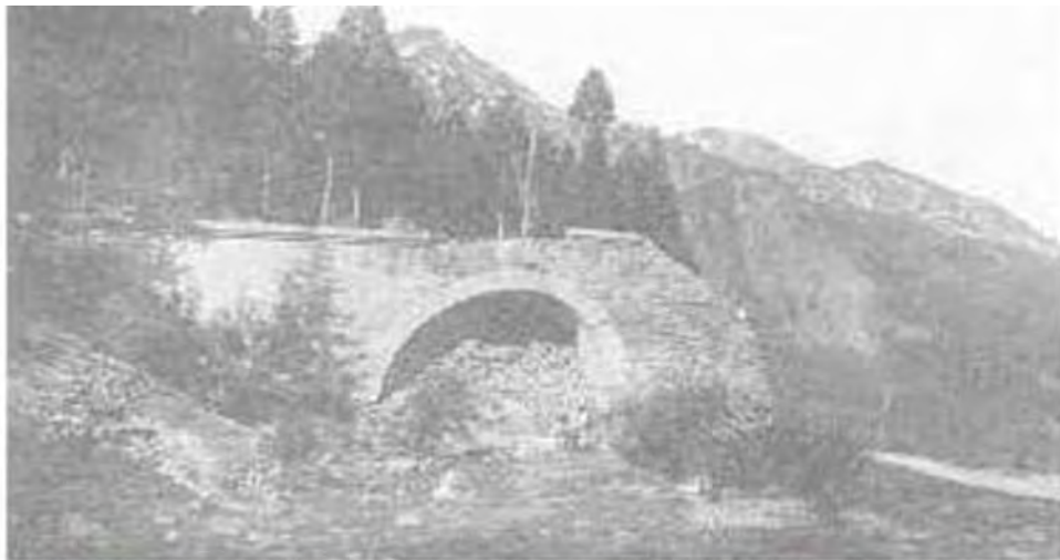
Foto 1a. L'imbocco Nord come si presentava subito dopo la frana del 1882.
