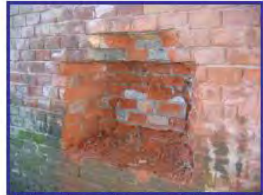
Particolare porzione muratura mancante
