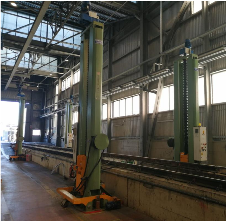
➤ IMPIANTO SOLLEVAMENTO CASSA
