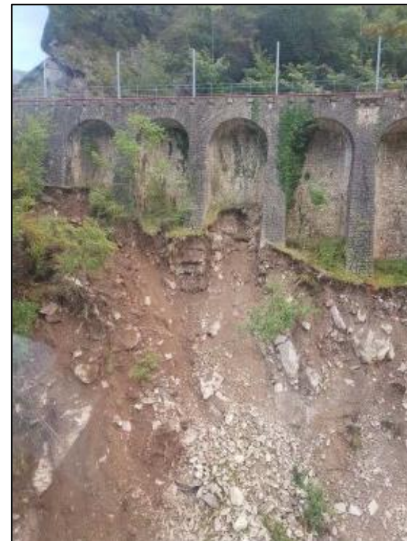
Erosione alla base del muro ad archi al km 69+217, a nord della stazione di Fontain La Sorge
