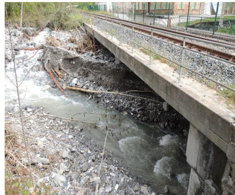
Ponte al km 41+560 sul fiume Roia (tra la stazione di Vievola e Tende): deposito di materiale alluvionale
