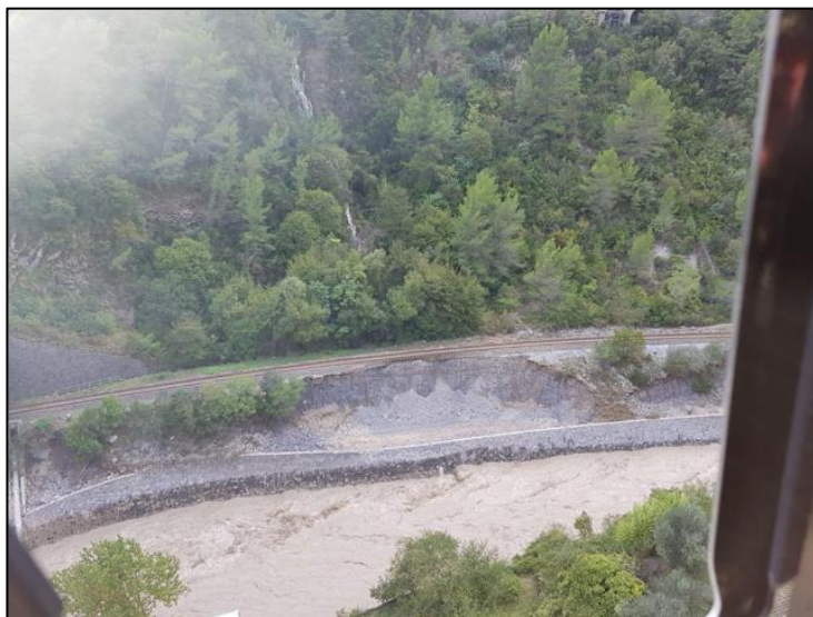
Erosione da parte del fiume Roia di un tratto di rilevato della lunghezza di circa 150 m, situato a sud della stazione di Breil Km 81+160 – km 81+323
