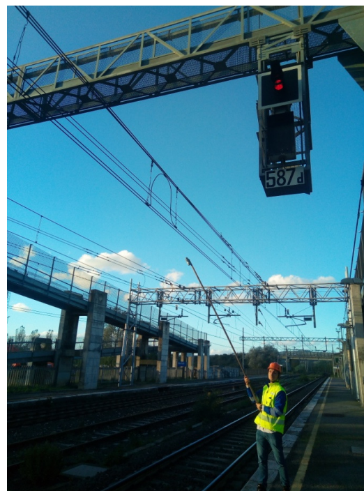
Prova sotto portale IS (segnale partenza Fabro)
