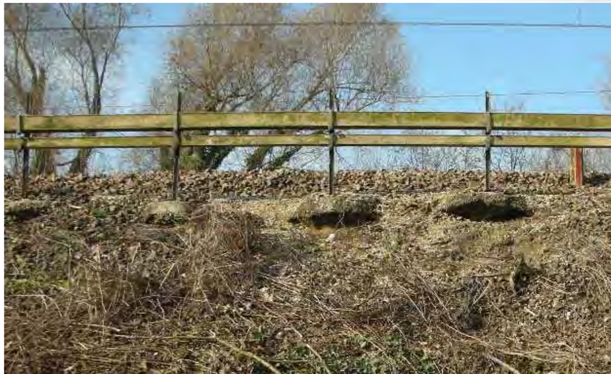
Cavidotto sospeso – scalzamento dei sostegni
